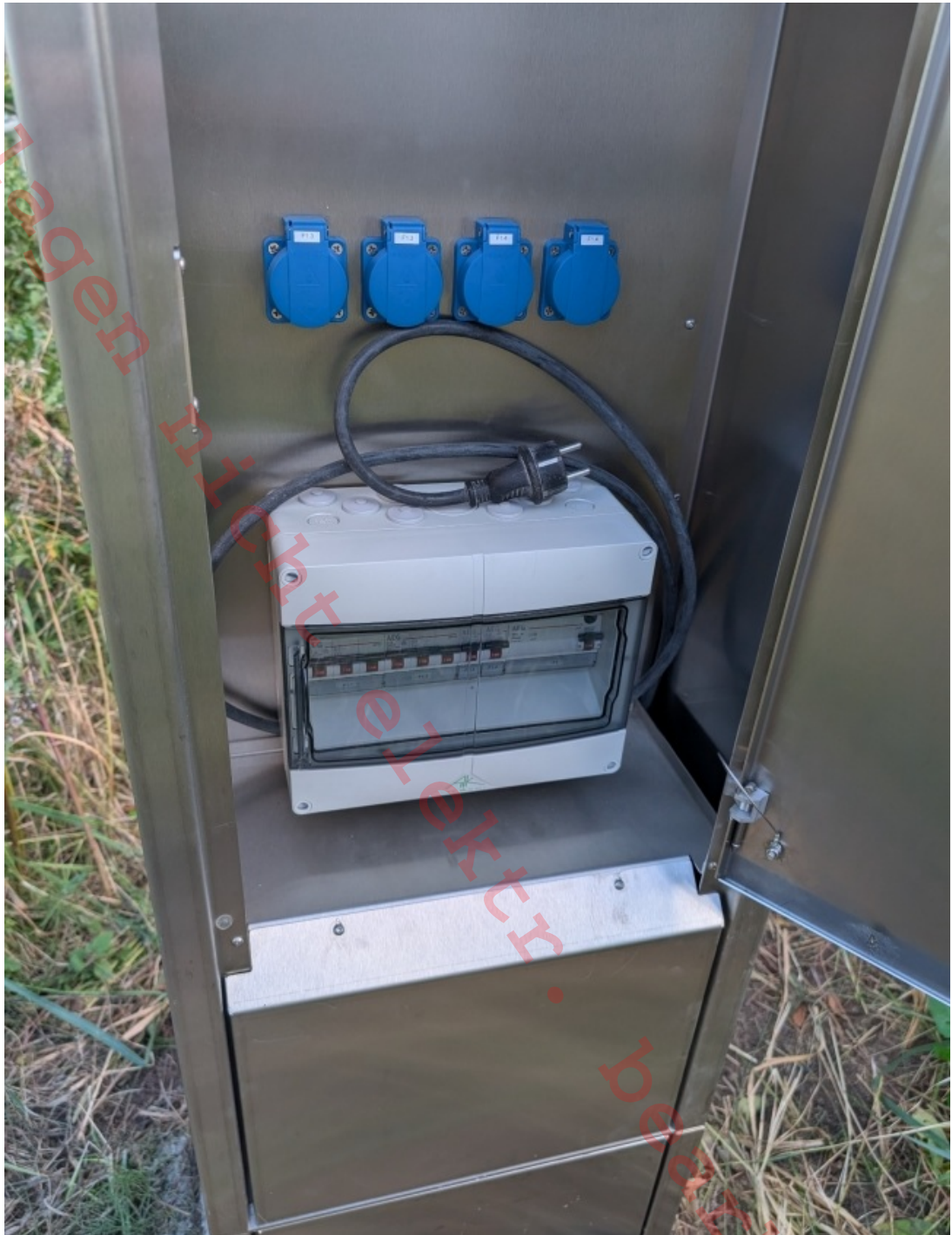
Schaltschrank für Stromanschluß
